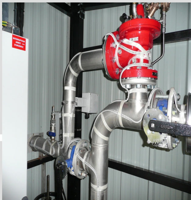
Traçage électrique de tuyauteries et d'accessoires
